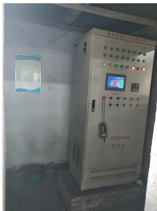
燃气炉控制系统
