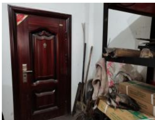
6、生活用房、淋浴室靠近2号厂房一面墙体处不应设门。
